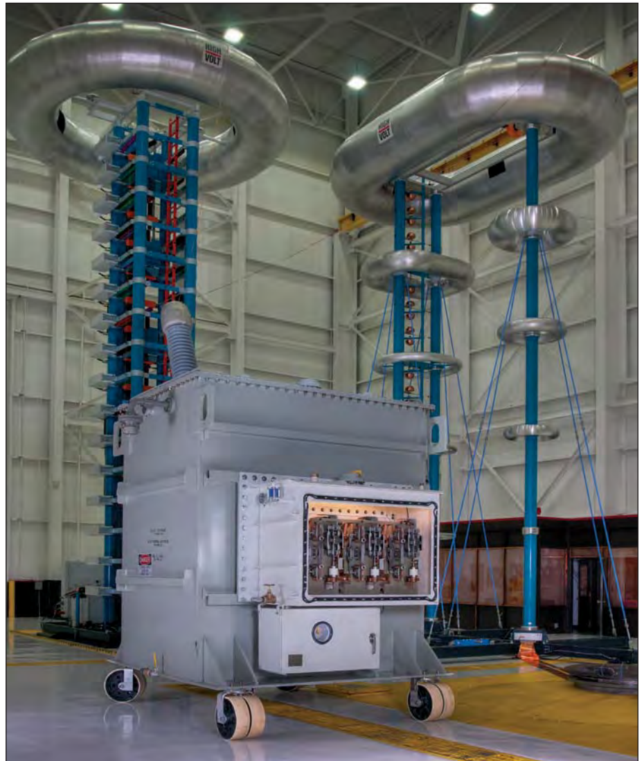
ABB社テネシー州アラモ施設に設置されている真空リアクタンス負荷時タップ切替器
